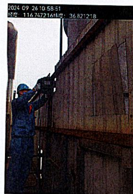
1#燃气轮机组排气筒 (DA001)
