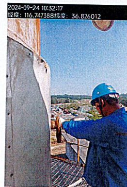
4#燃气轮机组排气筒 (DA019)
